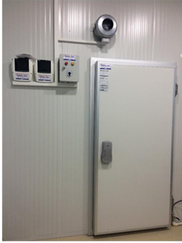
İklimlendirme sistemli bitki yetiştirme odası
